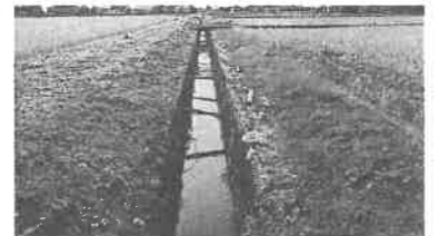
老朽化が著しい排水路
