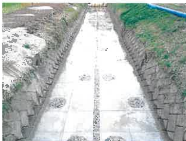
新農業水利システム保全対策事業 亀川排水路工事（一歩二歩地内）
